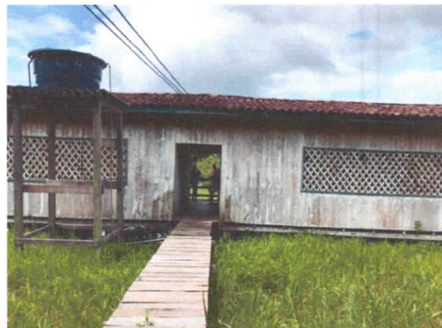
FOTO 14: VISTA EXTERNA APARTIR DOS FUNDOS, DETERIORAÇÃO DE SALAS DE AULA.
