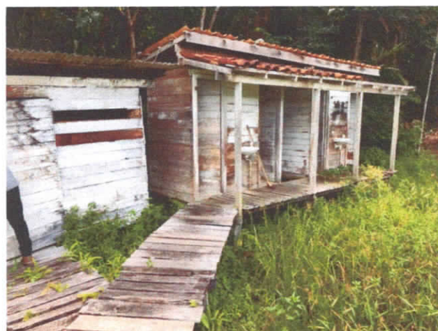
FOTO 15: VISTA DOS BANHEIROS EM DETERIORAÇÃO.
