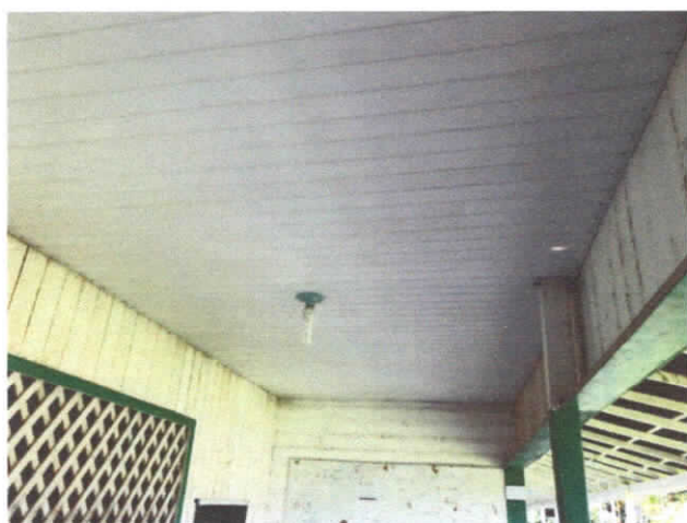
FOTO 09: DETALHE INTERNO DO FORRO DA COZINHA DETERIORADA.
