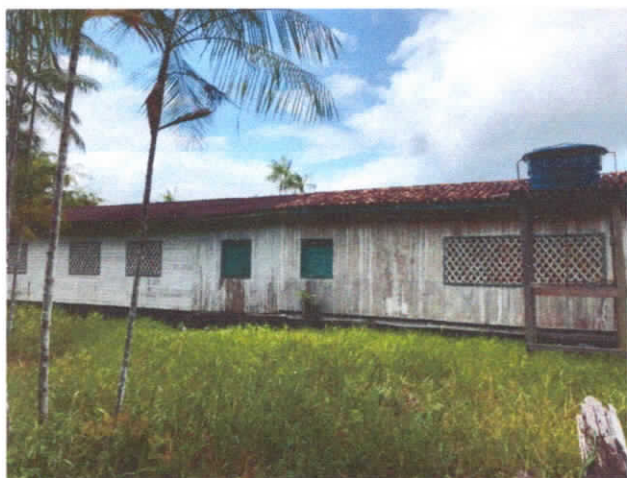
FOTO 03: DETALHE DA FACHADA POSTERIOR TODA DETERIORADA.
