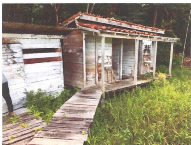
FOTO 15: VISTA DOS BANHEIROS EM DETERIORAÇÃO.
