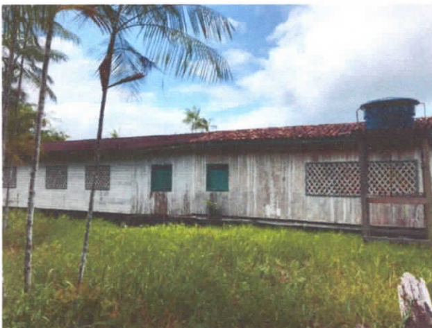
FOTO 03: DETALHE DA FACHADA POSTERIOR TODA DETERIORADA.
