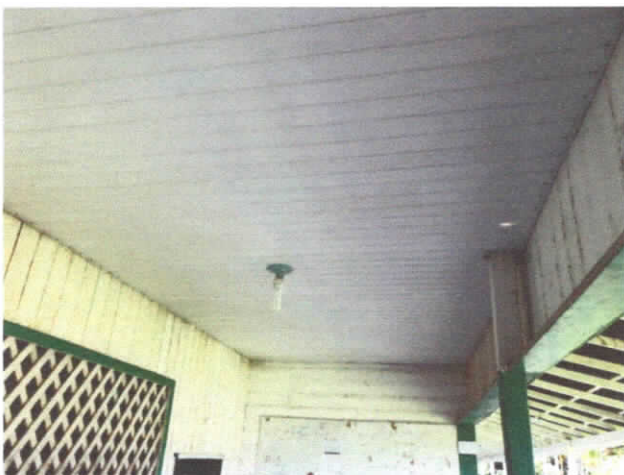
FOTO 09: DETALHE INTERNO DO FORRO DA COZINHA DETERIORADA.
