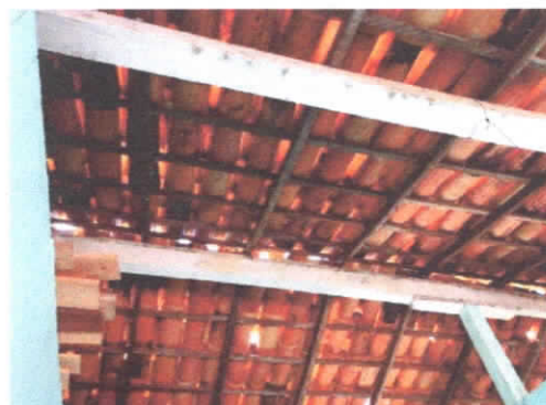
FOTO 13: DETALHE DA COBERTURA TODA DETERIORADA – ESCOLA DA ILHA ATURIÁ.
