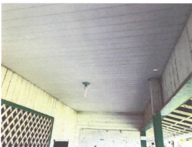
FOTO 09: DETALHE INTERNO DO FORRO DA COZINHA DETERIORADA.
