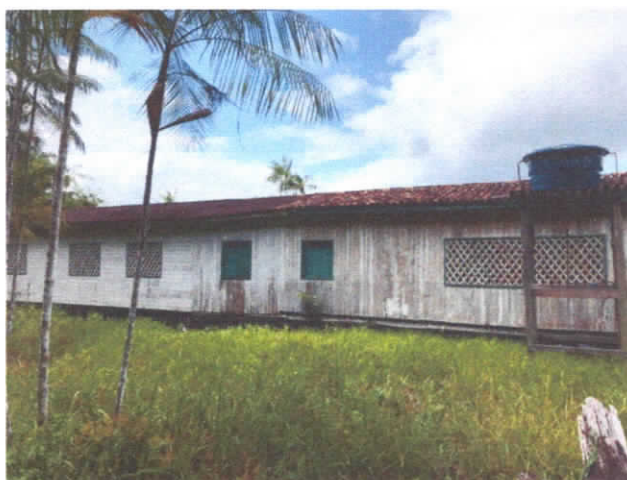
FOTO 03: DETALHE DA FACHADA POSTERIOR TODA DETERIORADA.
