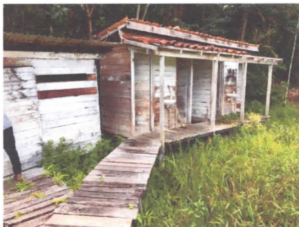
FOTO 15: VISTA DOS BANHEIROS EM DETERIORAÇÃO.
