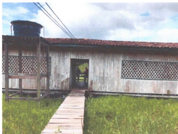
FOTO 14: VISTA EXTERNA APARTIE DOS FUNDOS, DETERIORAÇÃO DE SALAS DE AULA.
