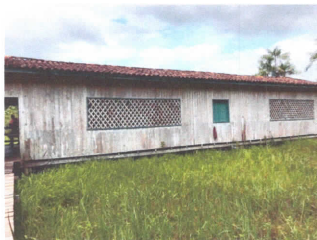
FOTO 04: VISTA DA FACHADA POSTERIOR, TODA EM MADEIRA E EM DETERIORAÇÃO.
