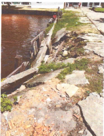
REGISTRO 03: DETALHE DE PARTE DA ORLA EM EROSAO – ARRIMO A CONSTRUIR.
