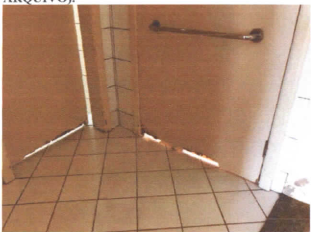
FOTO 40: DETALHE DE PORTAS DETERIORADAS DOS SANITÁRIOS DA RECEPÇÃO.
