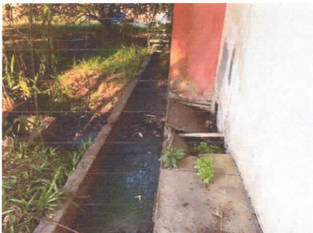
FOTO 28: VISTA DA DRENAGEM, CX. DE INSPEÇÃO E CALÇADAS DETERIORADAS.
