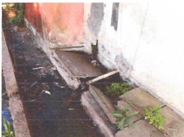
FOTO 26: DETALHE DA DETERIORAÇÃO DE CALÇADAS E DRENAGEM PLUVIAL.
