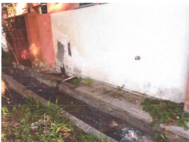
FOTO 25: DETALHE DA DETERIORAÇÃO DA DRENAGEM DOS FUNDOS DA COZINHA.
