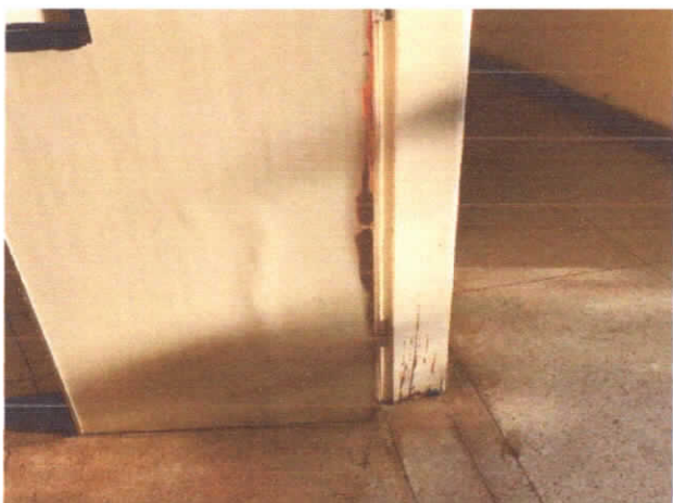
FOTO 43: VISTA DE PARTE DA PORTA P6 DETERIORADA DE ACESSO AO BLOCO DE SERVIÇO.
