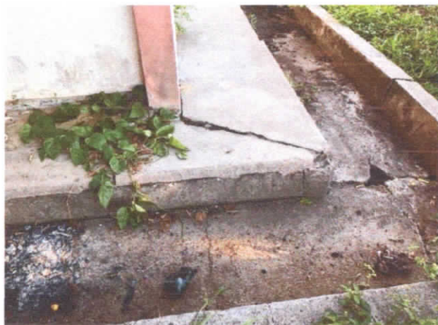
FOTO 29: DETALHE DE CALÇADAS DE PROTEÇÃO E DRENAGEM DETERIORADAS.
