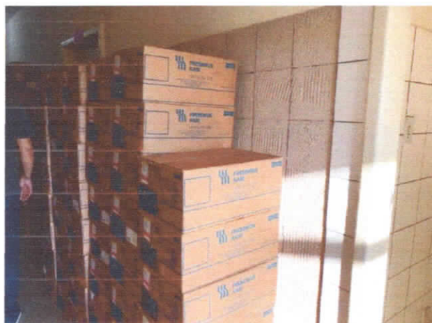
FOTO 42: VISTA DE PARTE DA CIRCULAÇÃO DO BLOCO DE SERVIÇO, C/ DESPLACAMENTO CERÂMICO.
