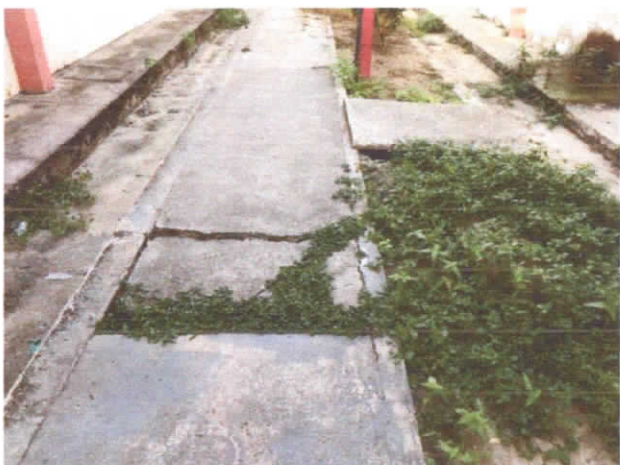
FOTO 21: DETALHE DE CALÇADAS DETERIORADAS ENTRE OS BLOCOS CIRÚRGICO E APOIO AO DIAGNÓSTICO.
