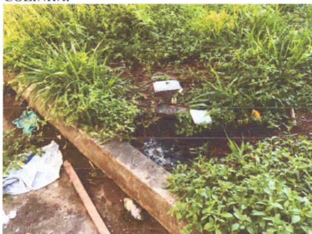
FOTO 32: VISTA PARTE DA DRENAGEM TOMADA PELA VEGETAÇÃO E DETERIORADA.
