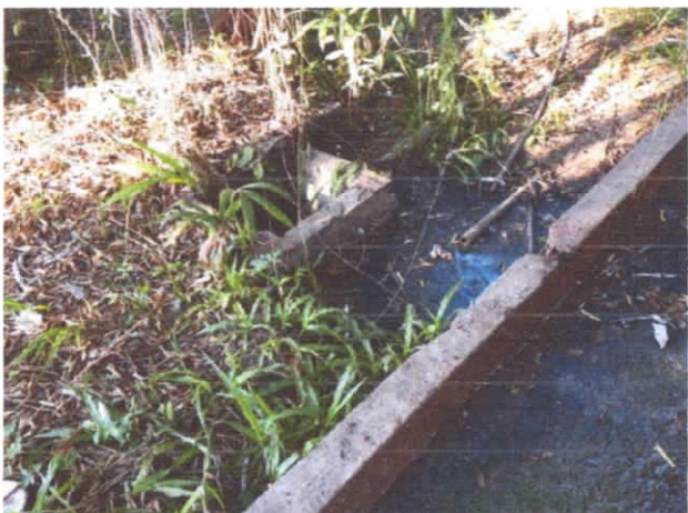
FOTO 27: VISTA DE PARTE DA DRENAGEM E CX. DE INSPEÇÃO DETERIORADOS.
