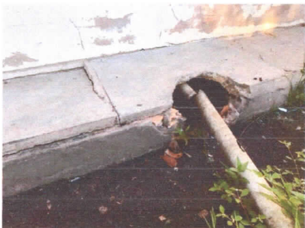
FOTO 31: VISTA DE TUBULAÇÃO DETERIORADA DE ESGOTO SECUNDÁRIO.
