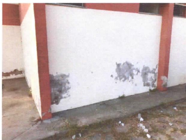
FOTO 08: VISTA DA FACHADA DO BLOCO ADMINISTRATIVO COM PINTURA DETERIORADA.
