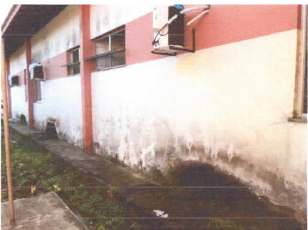
FOTO 15: VISTA EXTERNA DO BLOCO DE INTERNAÇÃO, PRESENÇA DE INFILTRAÇÕES.
