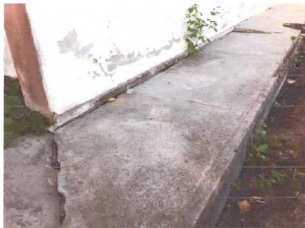
FOTO 30: DETALHE DA RUPTURA DE CALÇADAS DE PROTEÇÃO DOS FUNDOS DA COZINHA.
