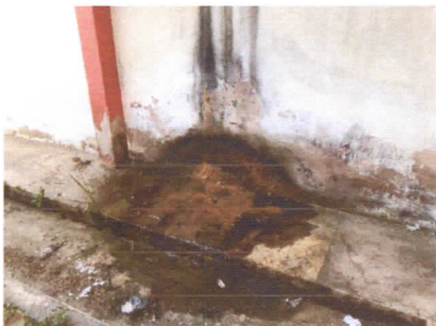
FOTO 19: DETALHE EXTERNO DOS PONTOS DE INFILTAÇÃO - AUSÊNCIA DE DRENOS DE AR CONDICIONADO.
