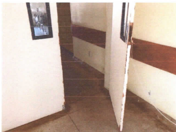
FOTO 41: VISTA PORTA P6 DETERIORADA SENTIDO SAÍDA CIRCULAÇÃO CENTRAL PRÓXIMO AOS SANITÁRIOS DA RECEPÇÃO.
