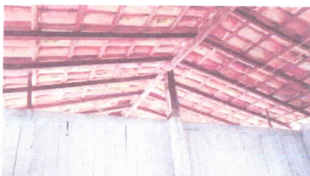
FOTO 12: VISTA DA COBERTURA TODA COMPROMETIDA PELO TEMPO DE USO.
