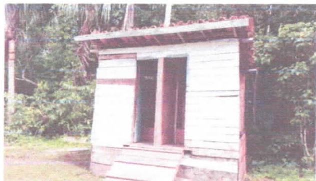
FOTO 07: VISTA DAS INSTALAÇÕES DO BANHEIRO ATUAL, INADEQUADO.
