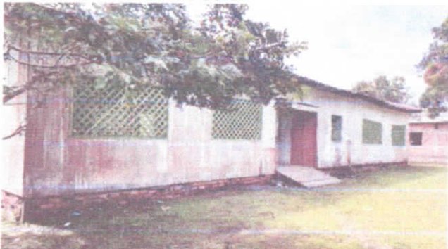
FOTO 04: DETALHE DA FACHADA POSTERIOR, ESCOLA DETERIORADA.
