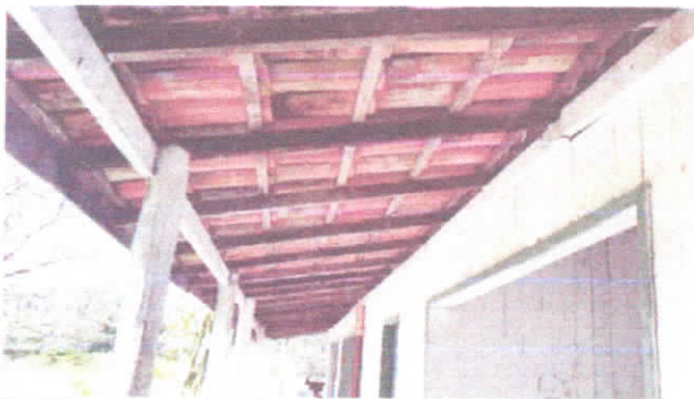
FOTO 09: VISTA DA COBERTURA DA CIRCULAÇÃO EM DETERIORAÇÃO.
