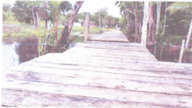
FOTO 21: VISTA DA CABECEIRA DA PASSARELA DE ACESSO À ESCOLA, EM DETERIORAÇÃO.
