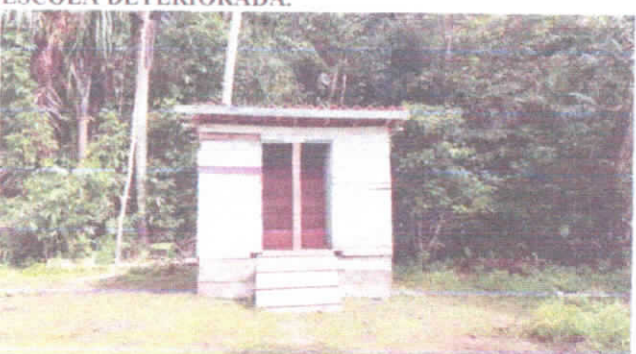
FOTO 06: VISTA DO BANHEIRO ATUAL, INFRAESTRUTURA INADEQUADA.
