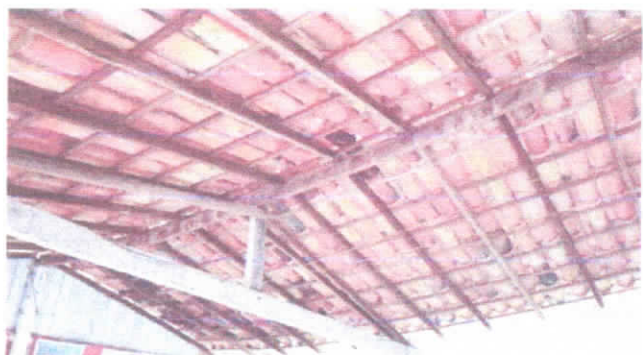
FOTO 18: VISTA DA COBERTURA, TELHAS E MADEIRAMENTO EM DETERIORAÇÃO.
