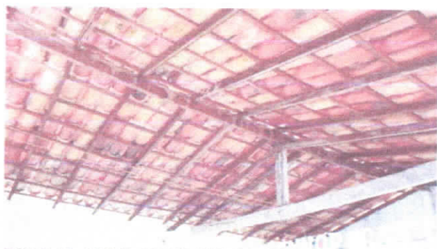
FOTO 13: VISTA DE PARTE DA COBERTURA EM DETERIORAÇÃO.
