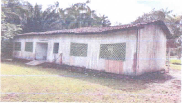
FOTO 03: DETALHE DA FACHADA POSTERIOR DA ESCOLA, TODA DETERIORADA.
