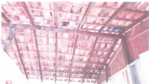
FOTO 17: VISTA DA COBERTURA TODA DETERIORADA.
