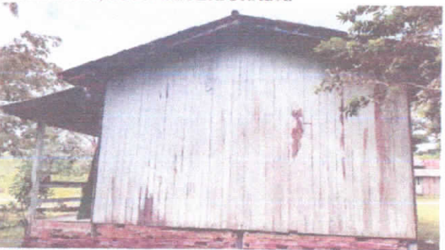
FOTO 05: VISTA DA LATERAL ESQUERDA DA ESCOLA, MADEIRA EM DETERIORAÇÃO.
