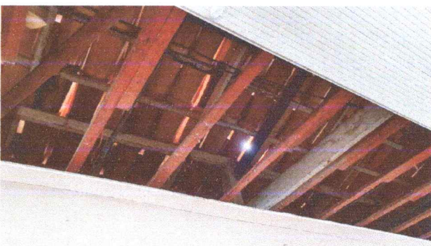
FOTO 10: VISTA DE PARTE DO FORRO PVC DA COBERTURA A REVITALIZAR.
