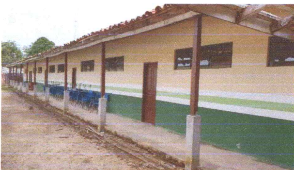
FOTO 27: VISTA DO BLOCO A ESTRUTURAR EM CONCRETO ARMADO E TROCA DE ESQUADRIAS.
