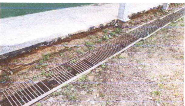
FOTO 09: VISTA DA CALHA DE PISO A RECONSTRUIR.
