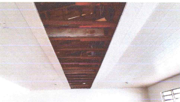
FOTO 12: VISTA DE FORRO PVC DETERIORADO A REVITALIZAR.
