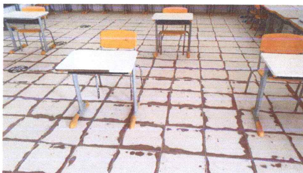
FOTO 06: VISTA DE PARTE DO PISO CERÂMICO DESGASTADO.
