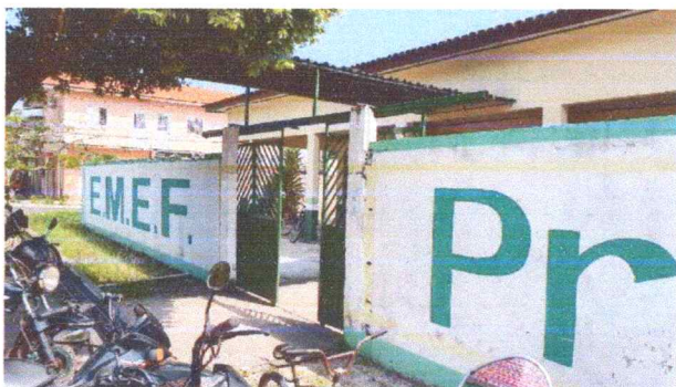
FOTO 01: VISTA DE PARTE DO MURO FRONTAL QUE APRESENTA MAIORES PROBLEMAS FÍSICOS.
