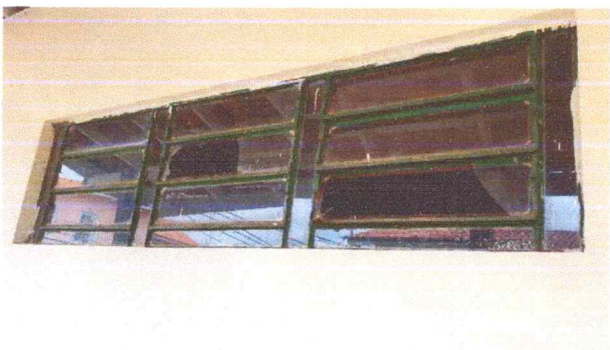
FOTO 07: VISTA DE ESQUADRIA DETERIORADA A SER TROCADA.
