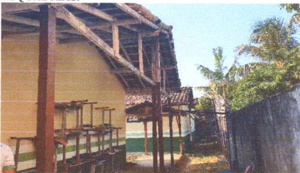
FOTO 23: DETALHE DA COBERTURA DETERIORADA À EXECUTAR NOVA C/ TELHAS PLAN.
