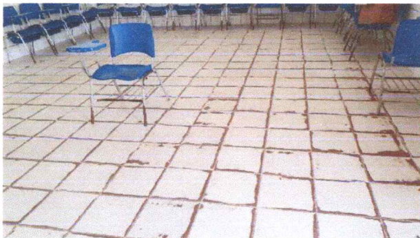
FOTO 15: DETALHE DO PISO DESGASTADO A TROCAR POR KORODUR.
