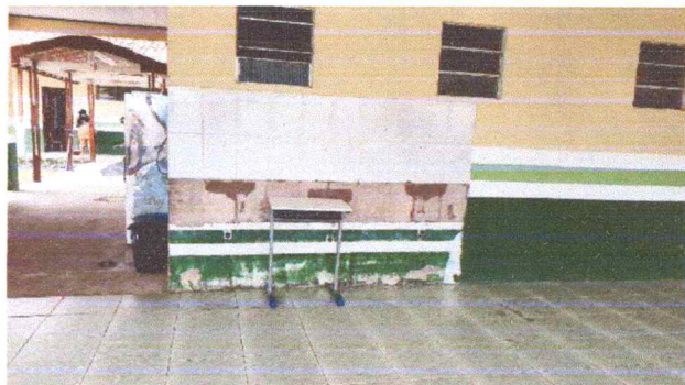
FOTO 04: DETALHE DE PARTE DA PAREDE INTERNA DETERIORADA, BLOCO DE SERVIÇO.
