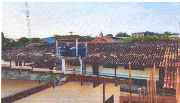
FOTO 03: DETALHE DA COBERTURA TODA DETERIORADA, INCLUSIVE FORRO E ELÉTRICA.
