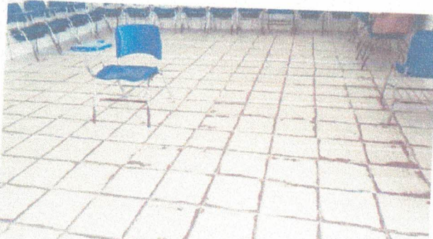
FOTO 15: DETALHE DO PISO DESGASTADO A TROCAR POR KORODUR.
