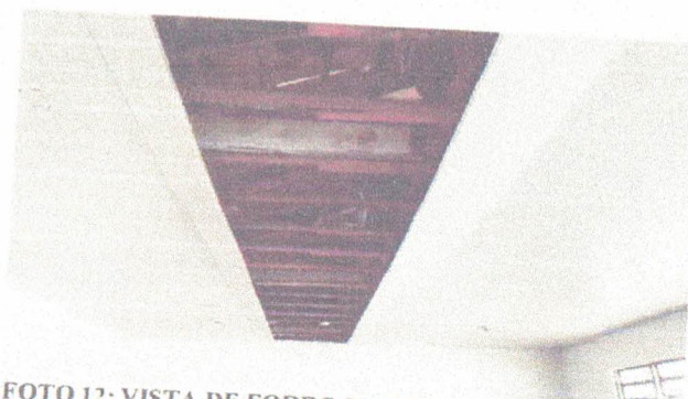
FOTO 12: VISTA DE FORRO PVC DETERIORADO A REVITALIZAR.
